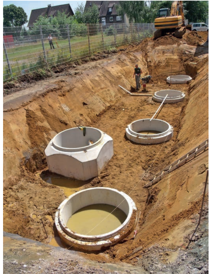
Abbildung 14: Unterirdische Speicherelemente (Stadt Bottrop, BEST AÖR 2025)
